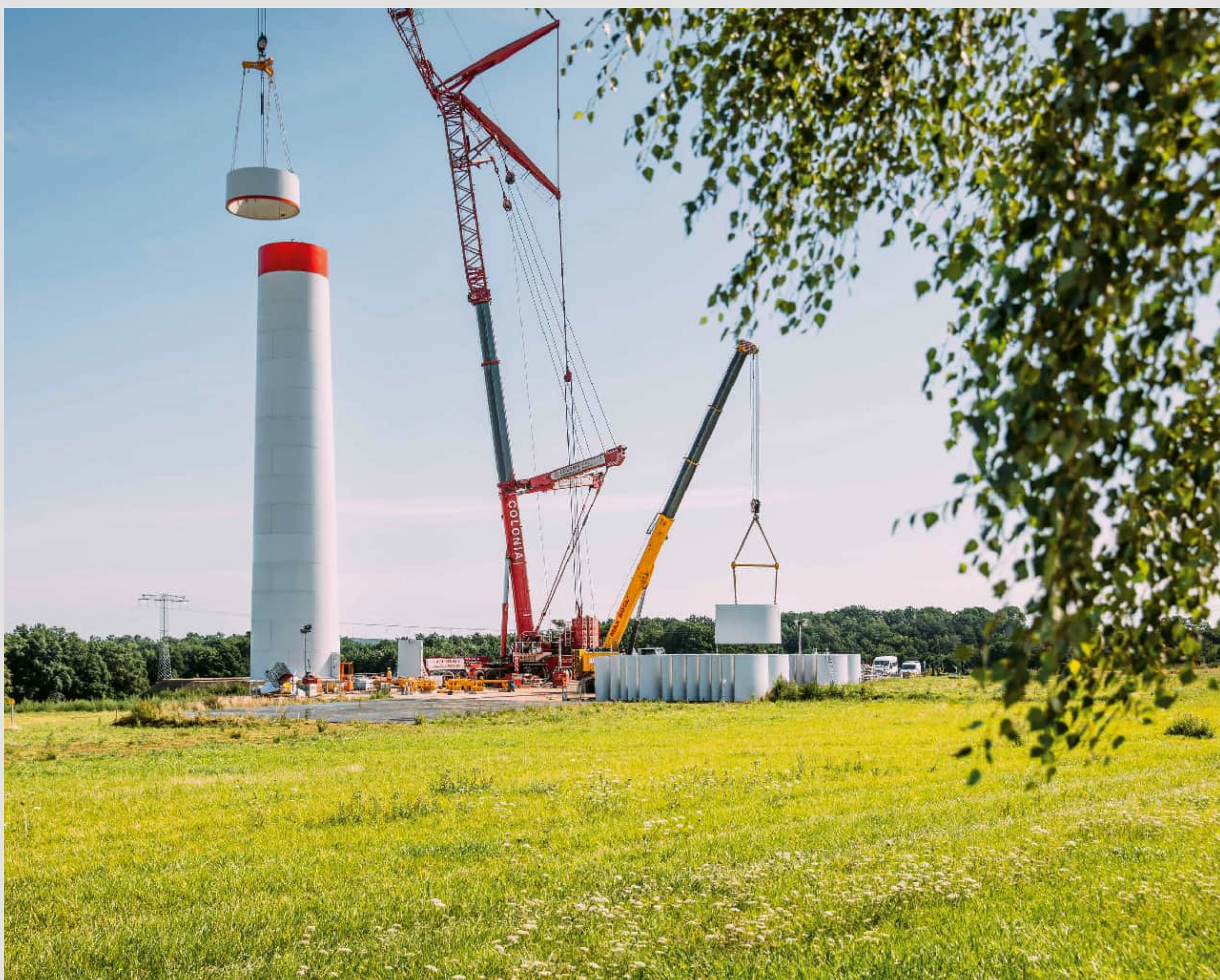
117 Personen haben während der Bauphase in den Windpark Reinsdorf investiert.
